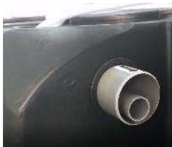
Foto 11 Tuberías de salida del agua tratada DN110 y DN50.
