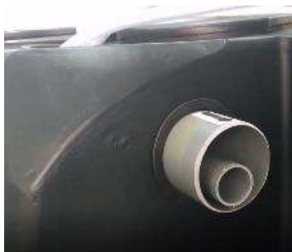
Foto 8 Tuberías de salida del agua tratada DN110 y DN50.
