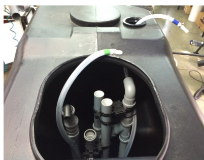
Imagen 3 Sistema Air-Lift instalado en el digester. Vista de las mangueras neumáticas.
