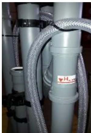
Imagen 11 Indicación de la altura H min en el depósito digestor
