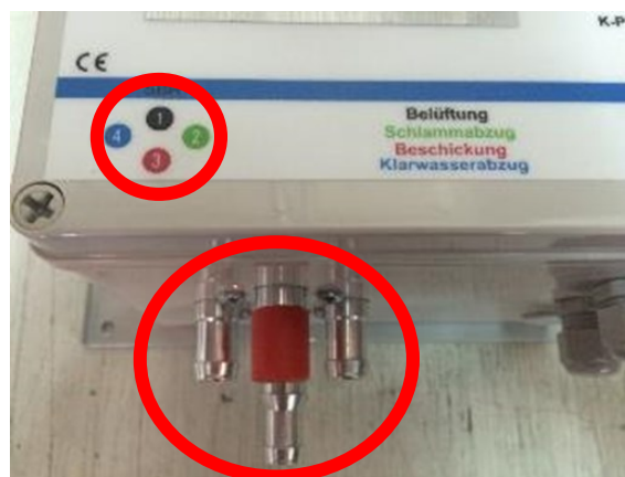
Imagen 10 Entronques para la conexión de las mangueras en el cuadro eléctrico
