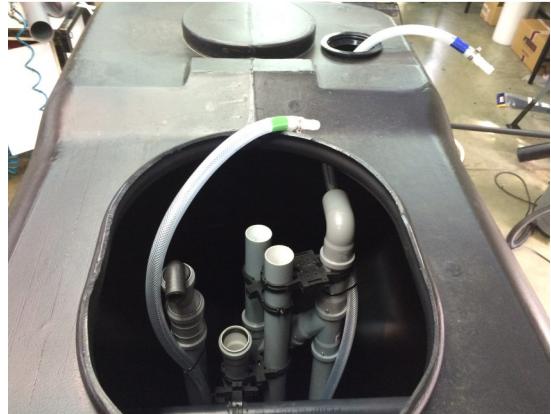
Imagen 3 Sistema Air-Lift instalado en el digestor. Vista de las mangueras neumáticas.
