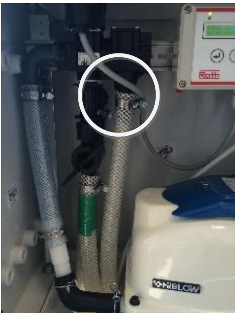
Imagen 13 Conexión de aireación de depósitos a través de los difusores. Se conecta a la salida sin etiqueta (lado derecho de la válvula 4V).
