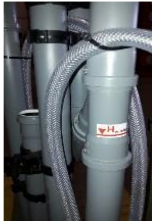
Imagen 15 Indicación de la altura H min en el depósito digestor
