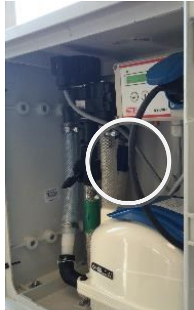
Imagen 12 Conexión de bombeo de agua tratada (pegatina azul). Se conecta a salida trasera de la Válvula 4V.
