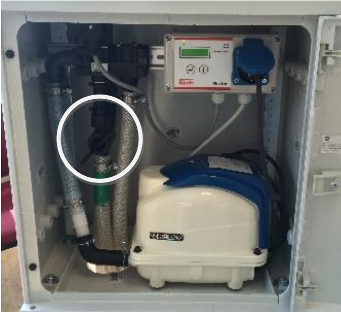
Imagen 11 Conexión recirculación de lodos (pegatina verde). Se conecta a la salida inferior de la Válvula 4V.
