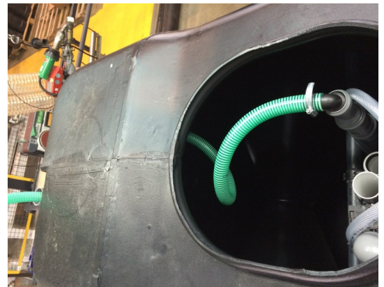
Imagen 5 Manguera corrugada en entronque del Air-Lift. Sale del depósito por el lateral hacia el depósito contiguo.
