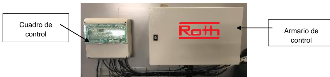
Fotografía 9: vista consola técnica, armario y foto interior del cuadro AquaServe 1000.
