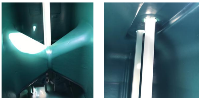
Fotografía 8: instalación interna de reactores.
